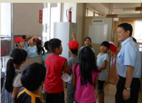
掃除ロッカーの上に消火器が！火災時、すぐに使えるでしょうか。こどもたちが問題点を見つけて指摘しています。
