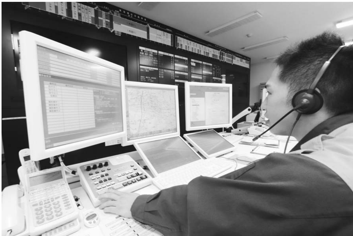
高機能消防指令センター
